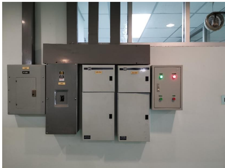
ภาพตู้ควบคุมระบบไฟฟ้า และสวิตช์เปิด-ปิดระบบระบายอากาศ
