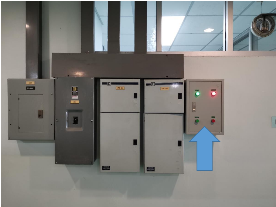
ภาพแสดงตู้ควบคุมระบบปรับอากาศภายในห้องฝึกทักษะฯทั้งหมด และปุ่มควบคุมการ เปิด-ปิด ระบบระบายอากาศ
