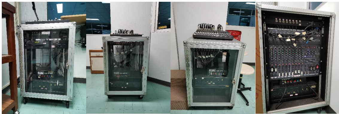
ภาพตู้ระบบควบคุมเสียง พื้นที่ทั้ง 4 ส่วนภายในห้องฝึกทักษะฯ
