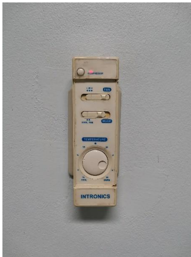
ภาพรีโมทควบคุมเครื่องปรับอากาศภายในห้องฝึกทักษะย่อย
